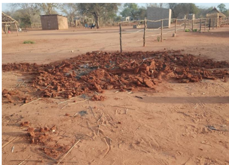
Estado em que ficou a casa de construção precária do vogal do MDM em Massangena
